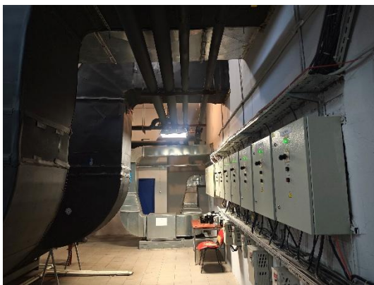
Технические помещения (на 2 тех. этаже)
