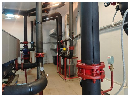
Технические помещения (на 2 тех. этаже)
