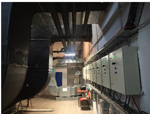
Технические помещения (на 2 тех. этаже)
