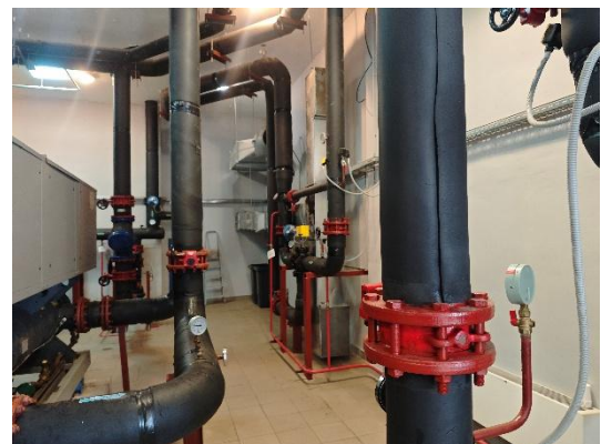
Технические помещения (на 2 тех. этаже)
