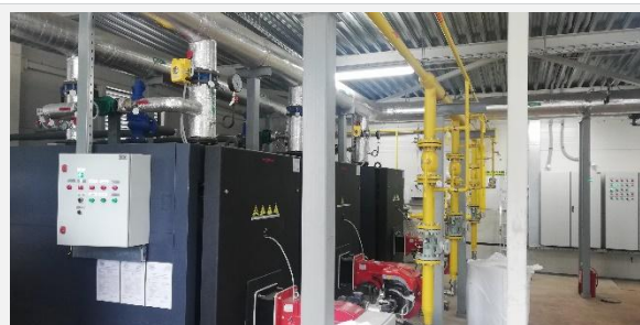
Техническое помещение (котельная)
