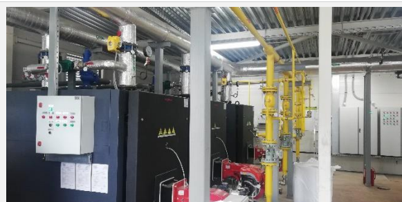
Техническое помещение (котельная)
