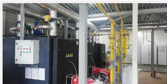
Техническое помещение (котельная)
